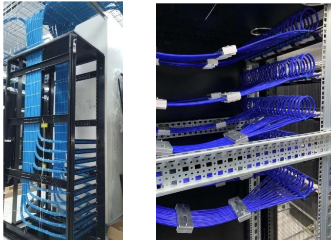
图 3 综合布线系统机柜内理线工艺
